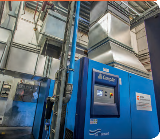
Ook de nieuwe toerengeregelde CompAir L90 is voorzien van ruim bemeten kanaalwerk om voldoende warmte af te voeren.
